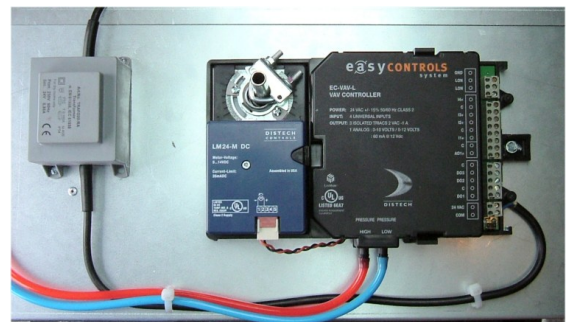
DCC regelaar met trafo
